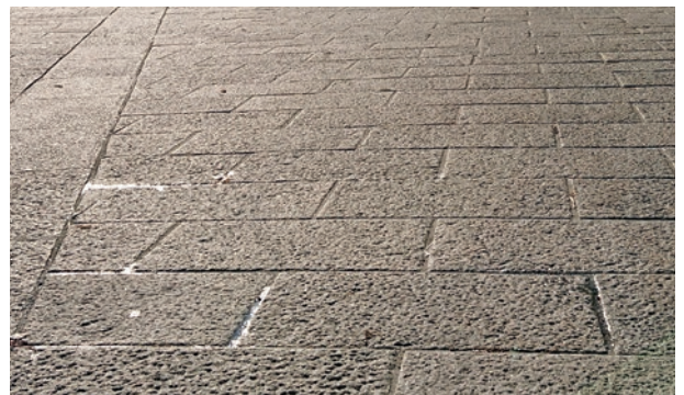
Bahnhofstrasse: Nach 20-jähriger Nutzung mussten einige Fugen zwischen den Granitplatten neu gegossen werden.
