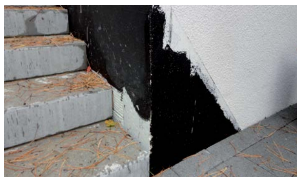
Befund vom Gemeindeammann: Fehlender Verputz bei einem Treppenabgang.
