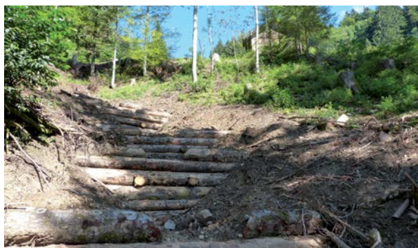
Rundholzsperrungen verbessern am Fälmisbach die Hochwassersicherheit.
